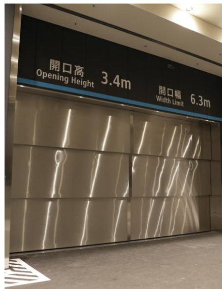
荷物用エレベーター
