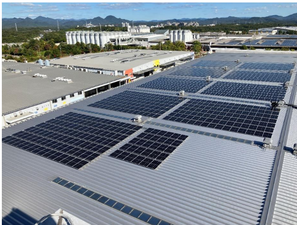
（参考写真）神戸事業所の太陽光パネル
